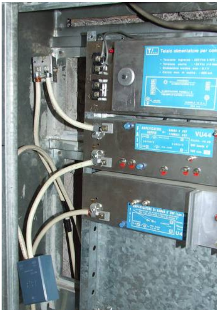
Fig. 5: Trappole installate in prossimità della centralina TV
